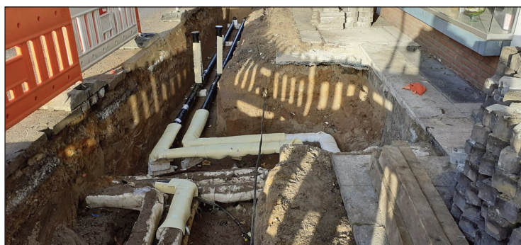
Archivfoto vom Fernwärmeanschluss des Lukashauses
